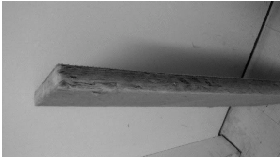
Kuva 3. Noin 40 vuotta vanha huonokuntoinen levy, jonka reunat ovat käsittelemättömät.
